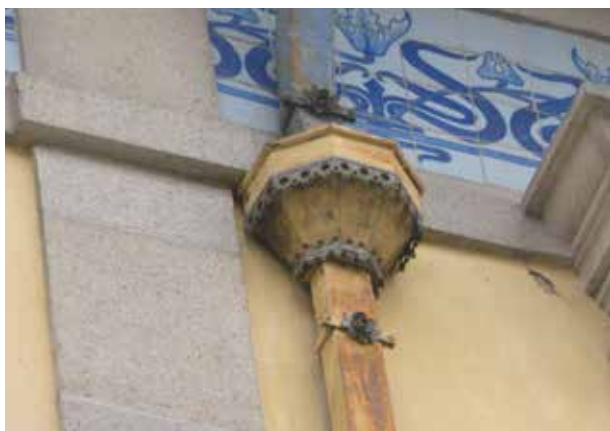
Caixas de descarga
