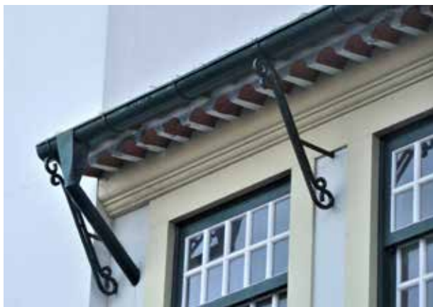
Tubos de queda interior e exterior
