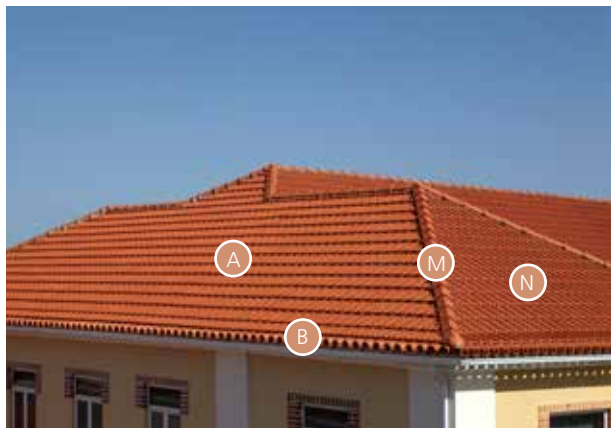
Água mestra (A), rincão ou guieiro (M), tacaniça (N) e beirado (B)
