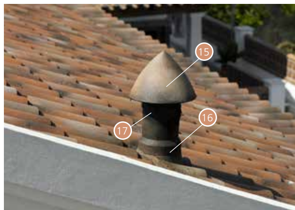
Conjuntos cerâmicos de chaminé
