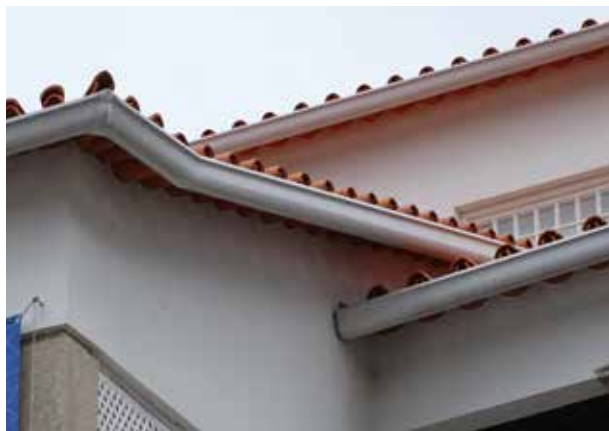
Algerozes fixados ao telhado e fixados à parede
